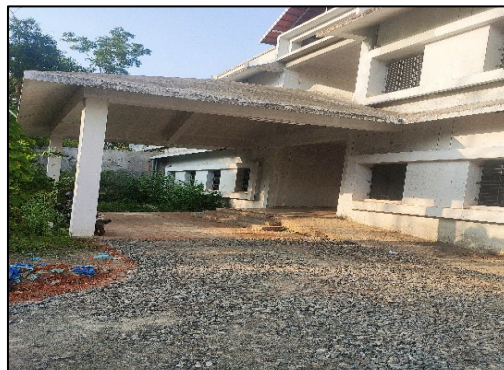
ചിത്രം 2.14 : കോഴിക്കോട് എസ്.എ.ആർ.ബി.ടി.എം -ന്റെ അക്കാദമിക് ബ്ലോക്ക് കോണിപ്പടി പൂർത്തിയായിട്ടില്ല
