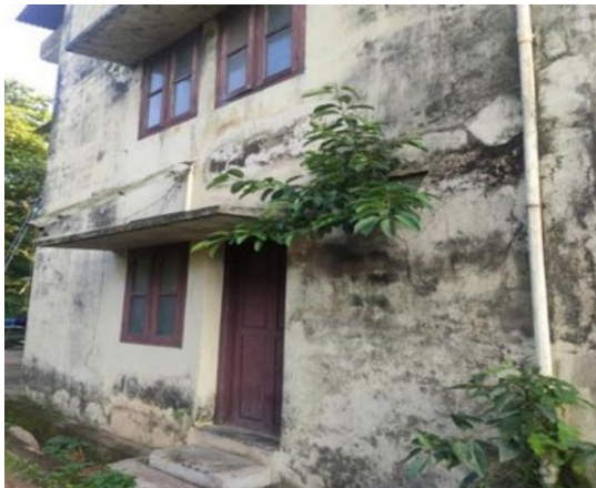
ചിത്രം 2.19 : കോഴിക്കോട് പാവമണി ക്വാർട്ടേഴ്സിലെ വിള്ളലുകളും സസ്യവളർച്ചയും
